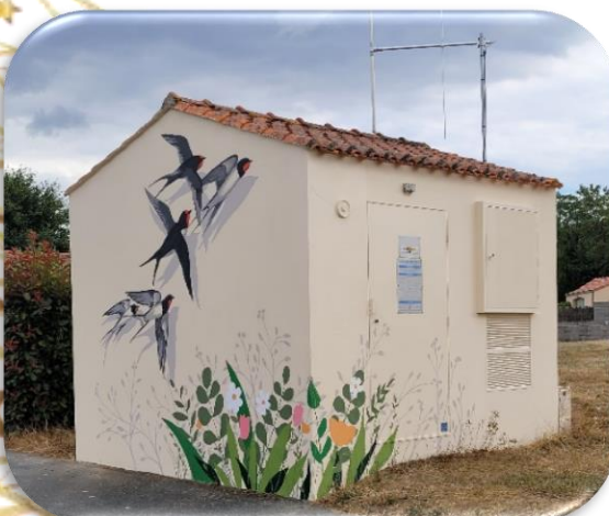
Embellissement du transformateur - Les Mètives
