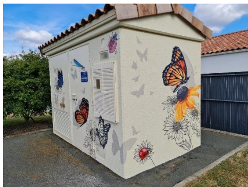
Embellissement du transfo Rue des Prunelles
